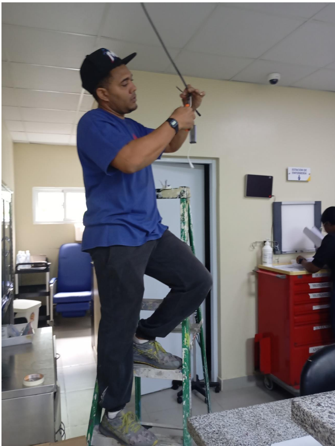
Mantenimiento correctivo cambio de lámpara 2x2 en estación de enfermería 28/01/2025.
