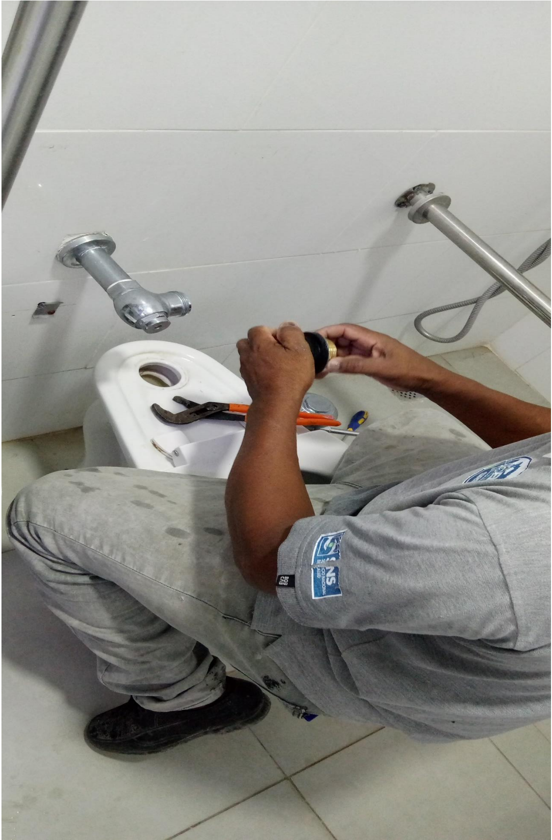
Solucion a fuga de agua 18/03/2024
