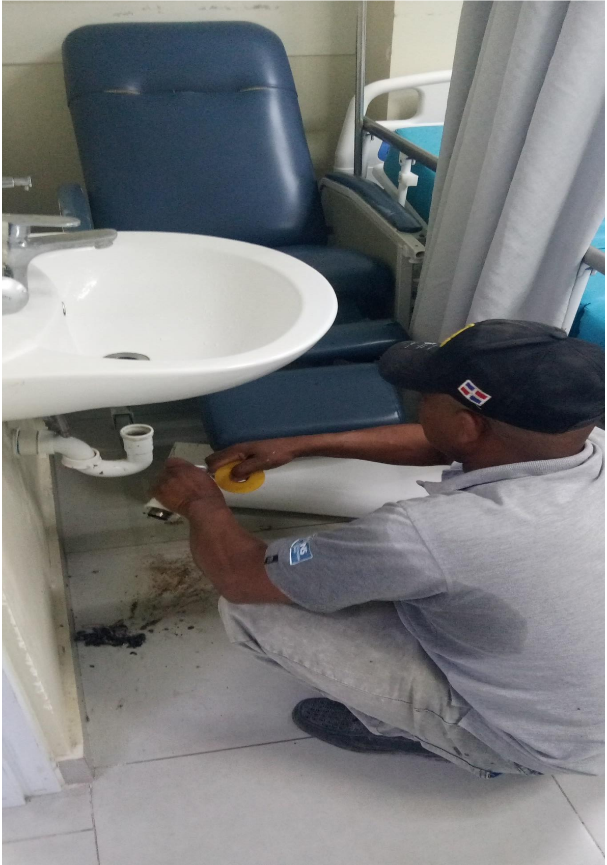
Solucion a fuga de agua 18/03/2024
