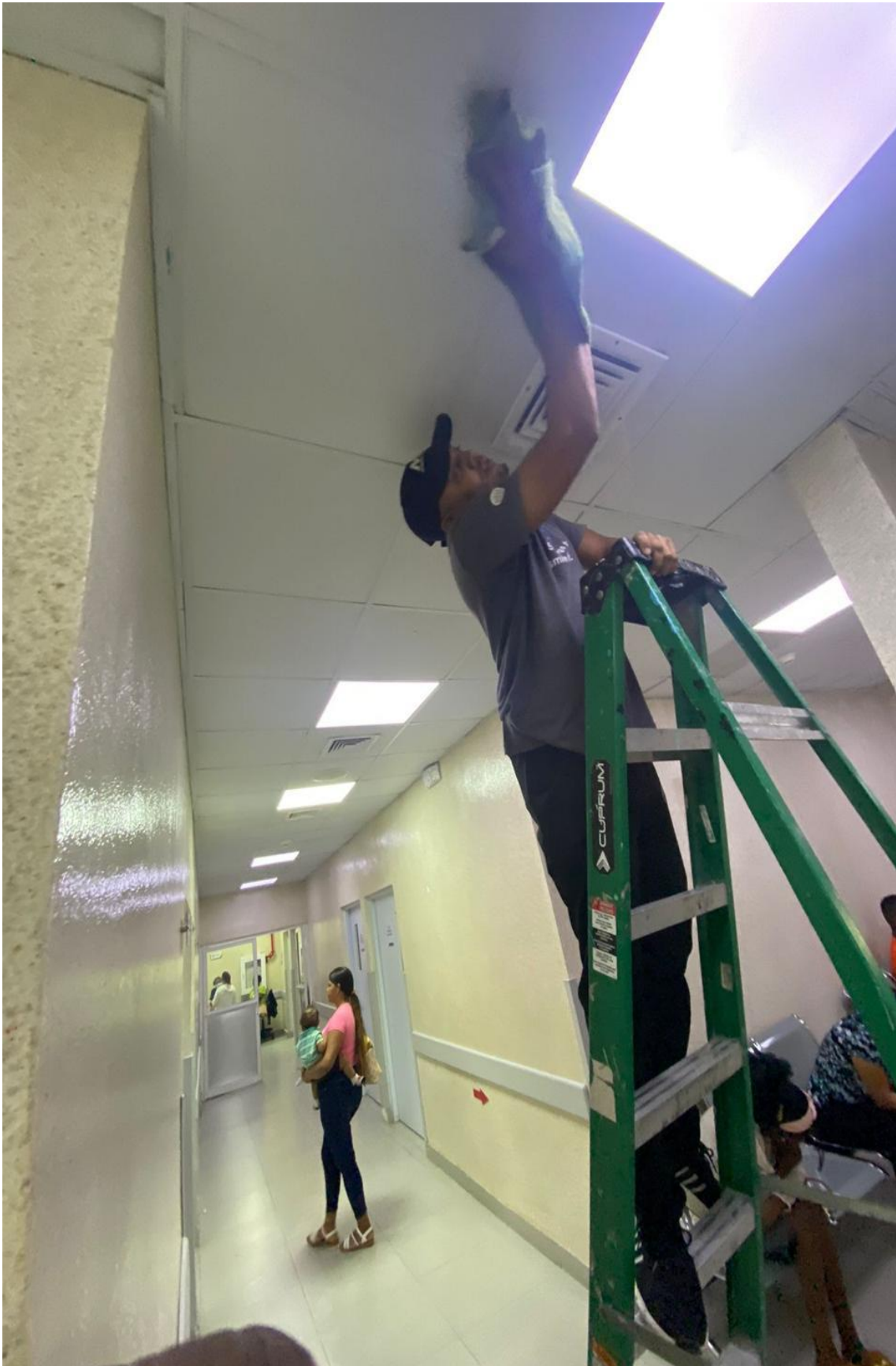
Limpieza de rejilla de aire 6/03/2024
