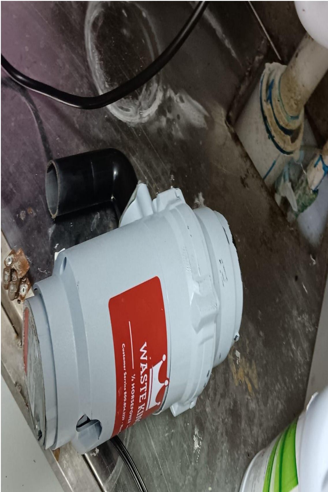
Cambio de bomba trituradora 14/03/2024
