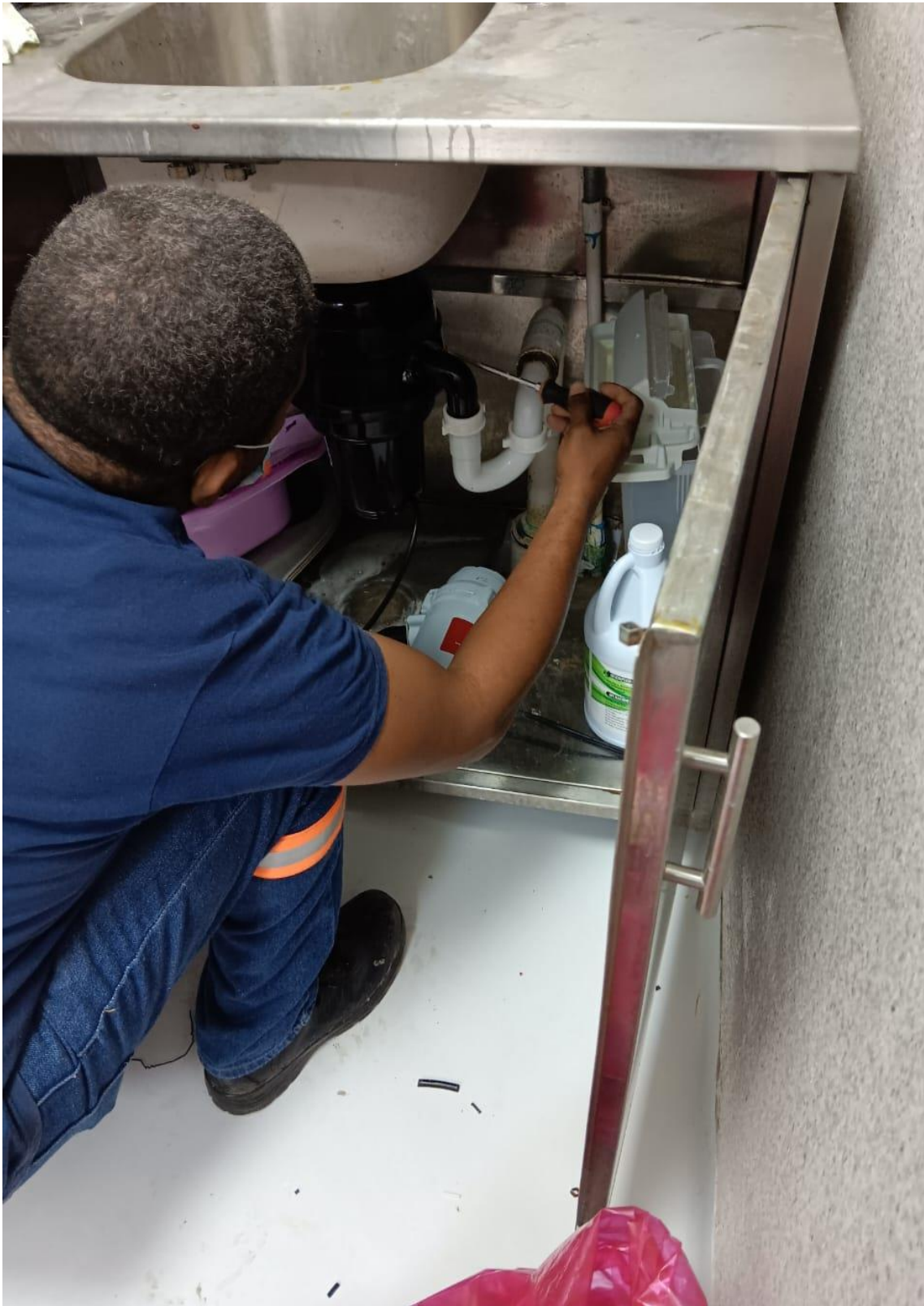
Cambio de bomba trituradora 14/03/2024
