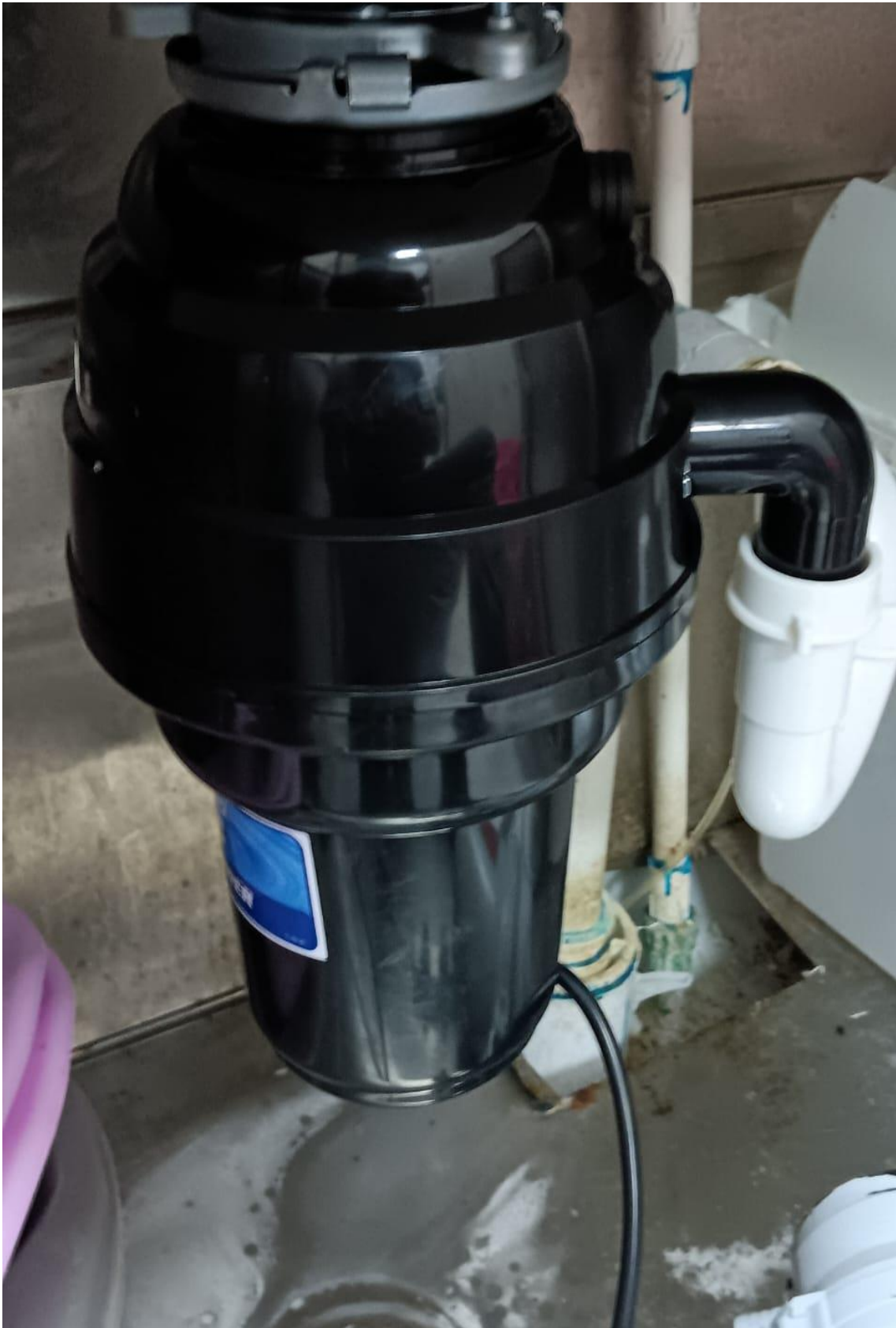
Cambio de bomba trituradora 14/03/2024
