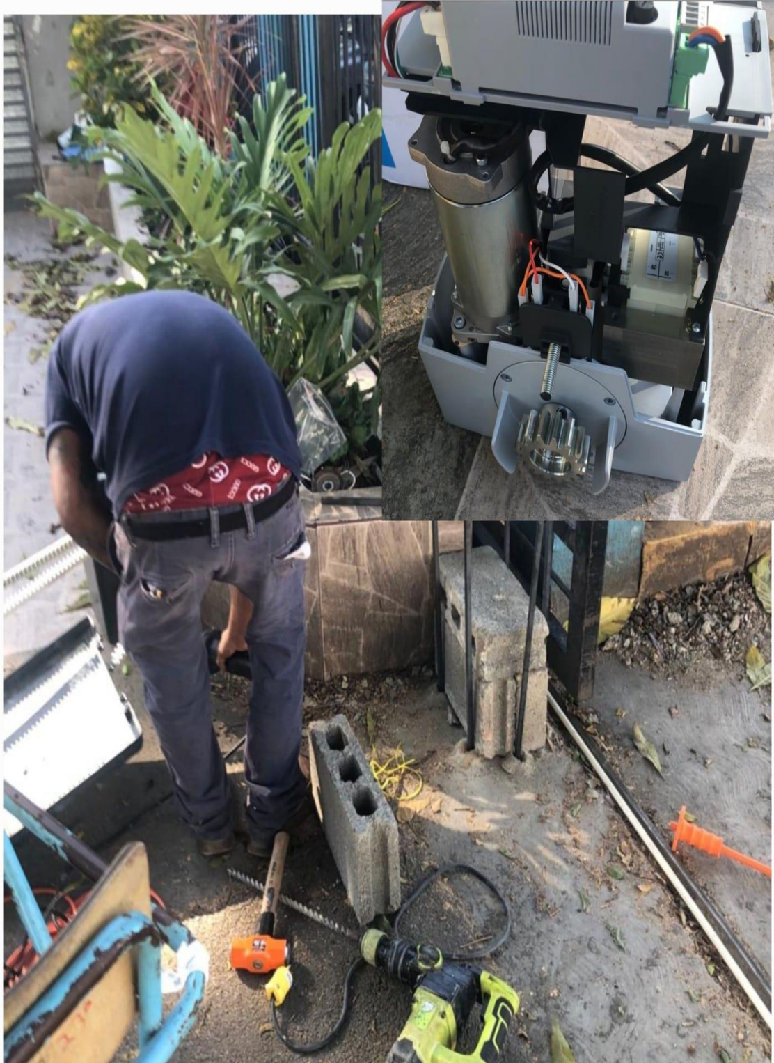
Motor Eléctrico del Portón Parqueo Personal Administrativo (Durante)
