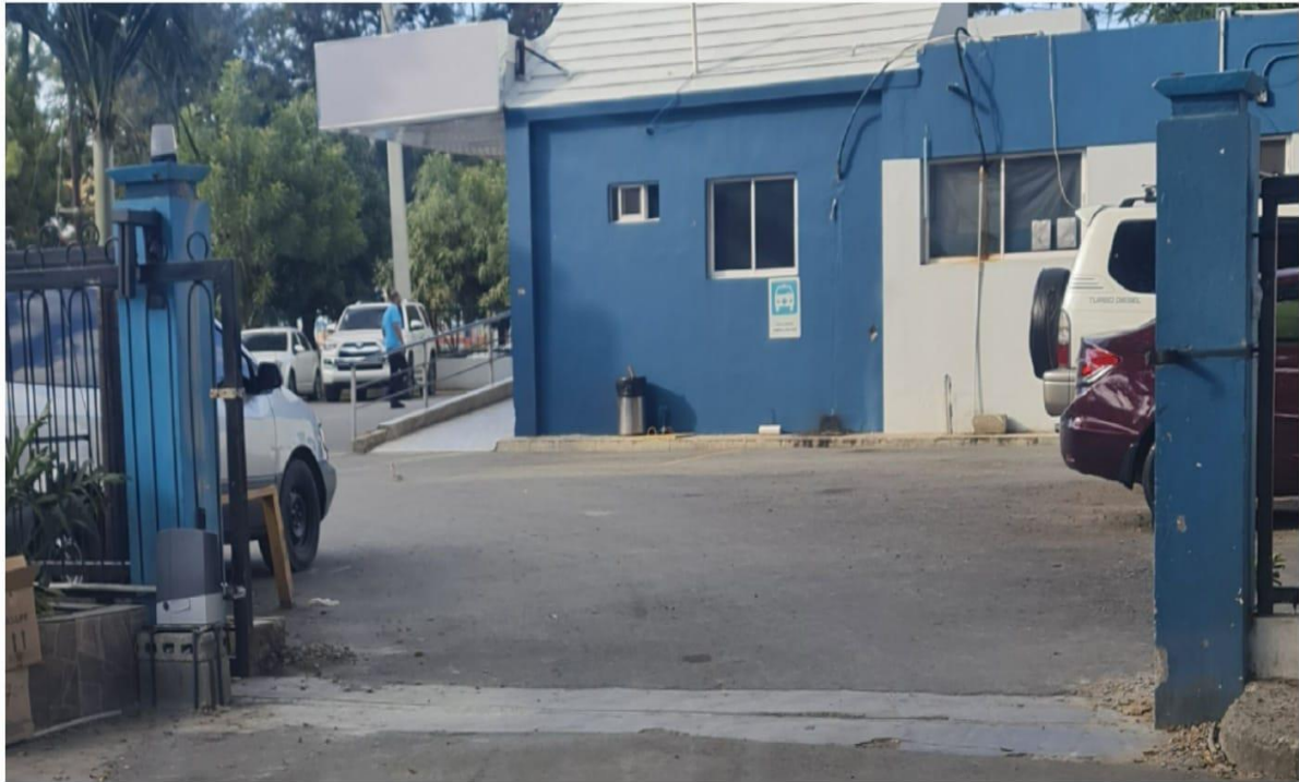
Motor Eléctrico del Portón Parque Personal Administrativo (Ahora)
