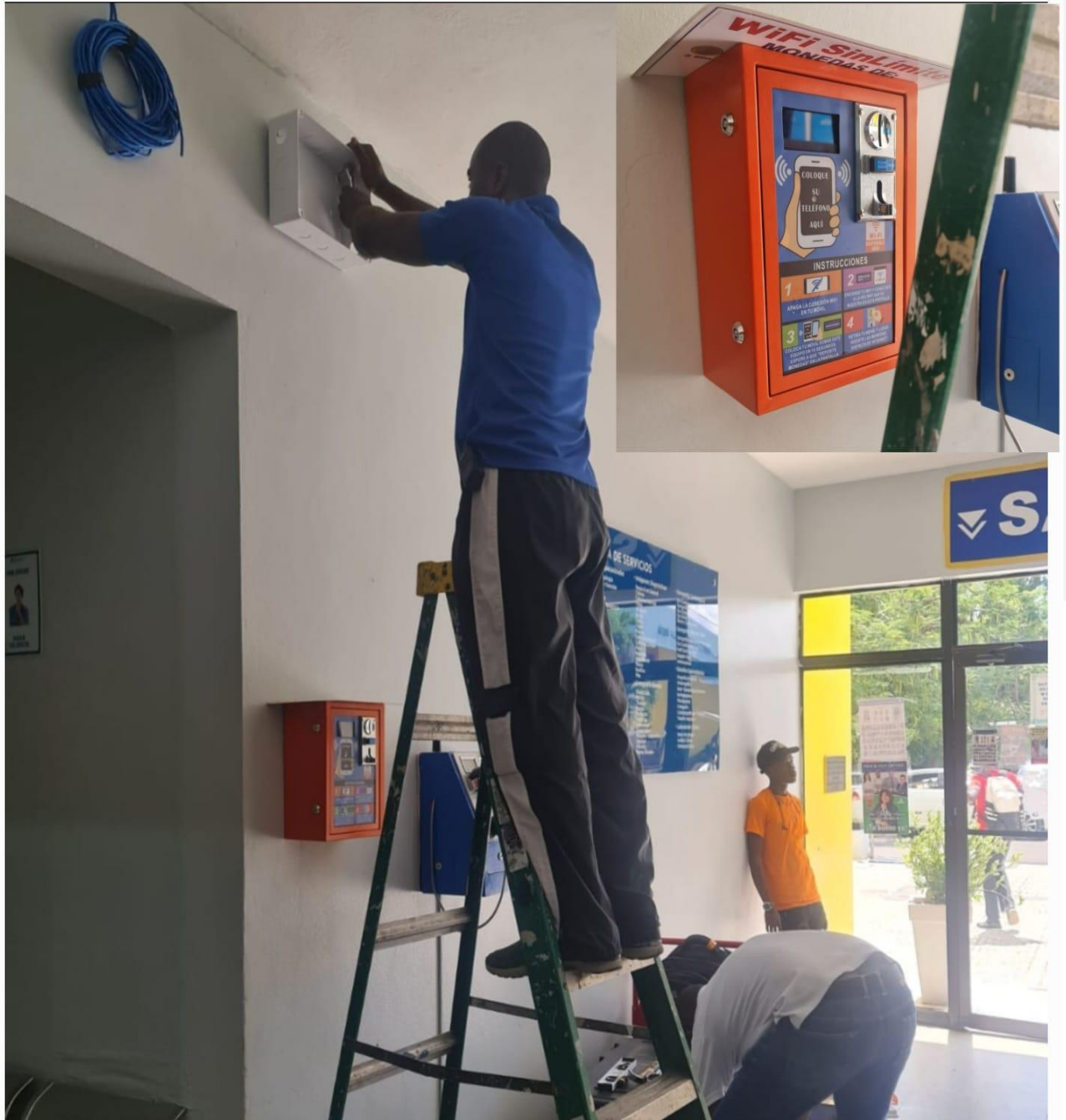
Colocación de Central WIFI para Colaboradores y Usuarios
