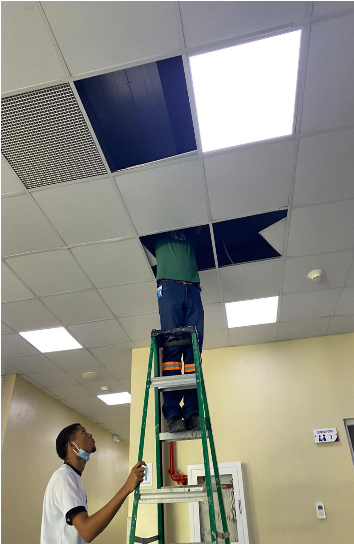
Aire acondicionado de sala de espera 23/02/2024
