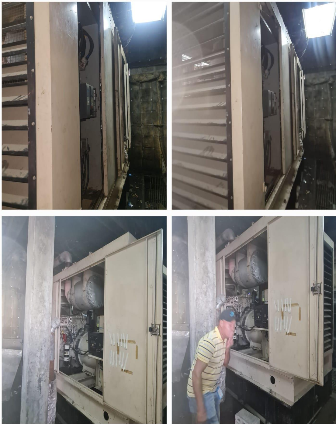
Mantenimiento de Planta Eléctrica
