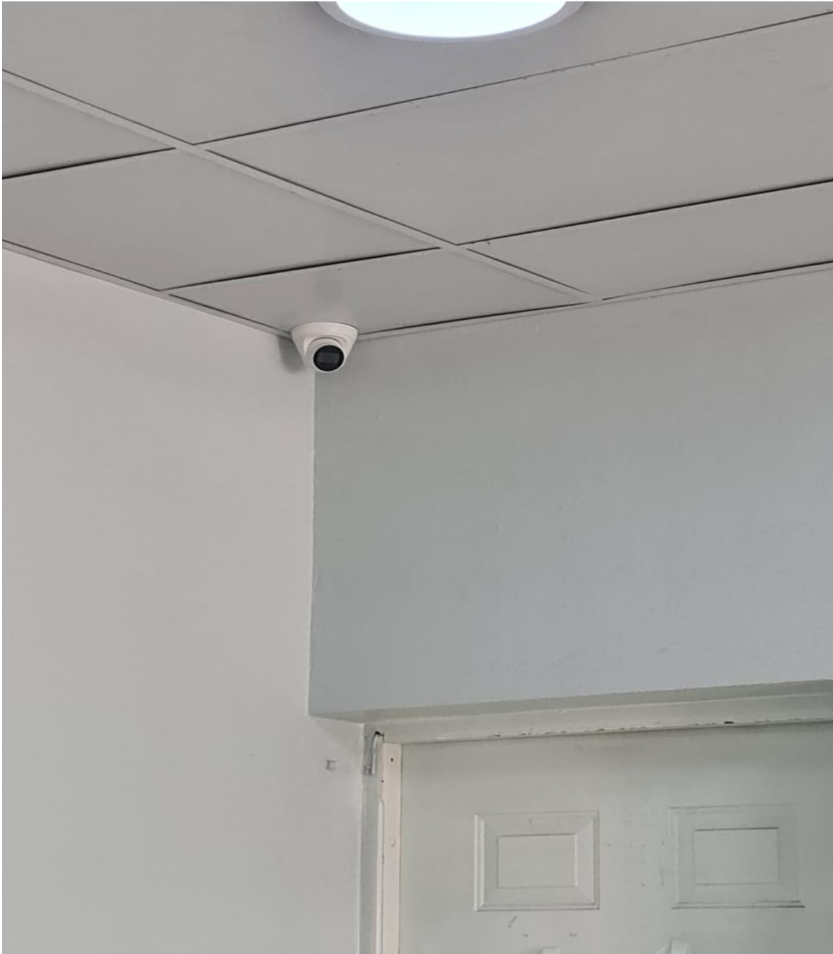
Colocación de Cámaras en diferentes Áreas
