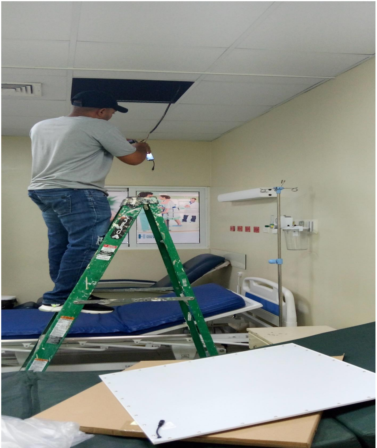
Cambio de lampara en internamiento 18/01/2024
