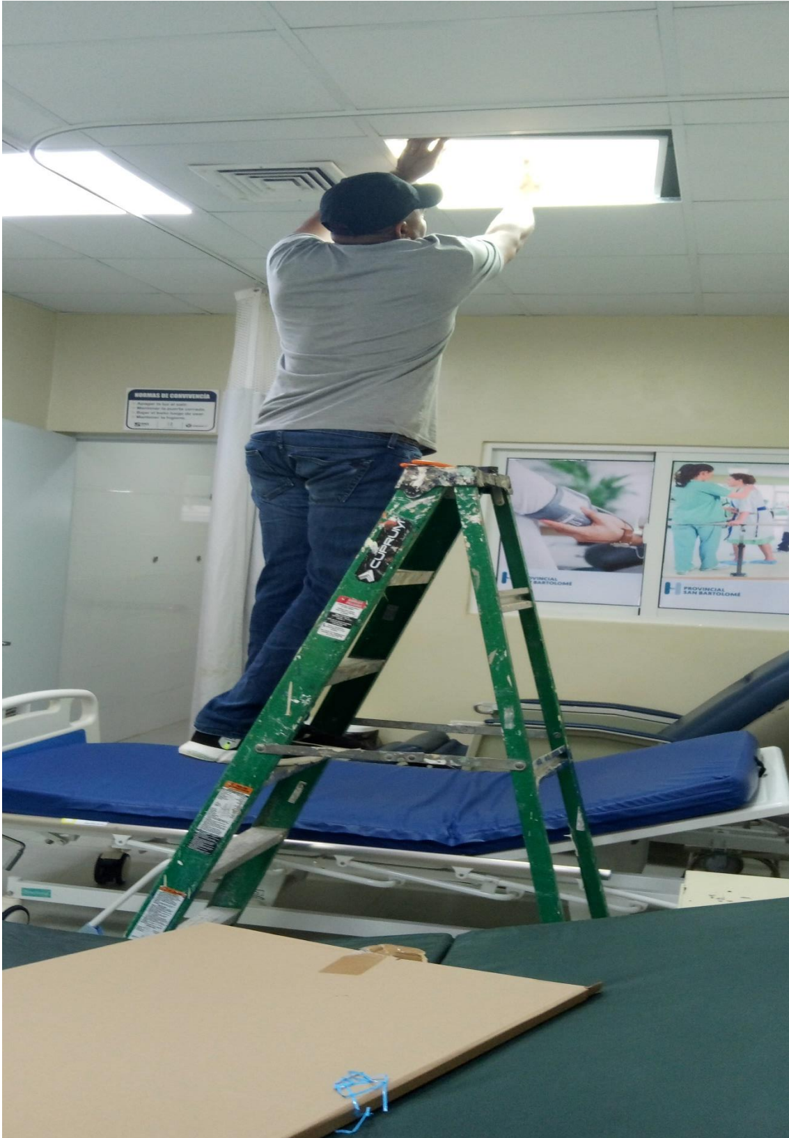
Cambio de lampara en internamiento 18/01/2024
