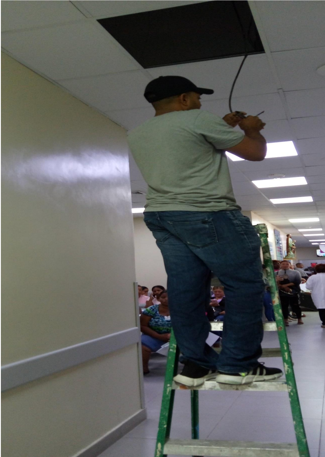
Cambio de lampara en internamiento 18/01/2024
