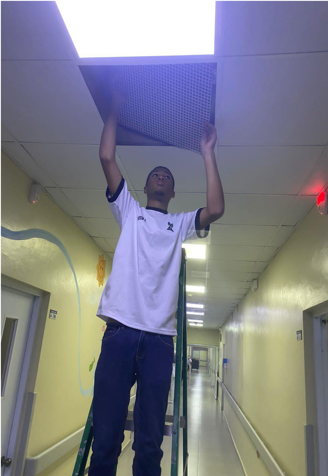
Limpieza de filtros internamiento 12/01/2024
