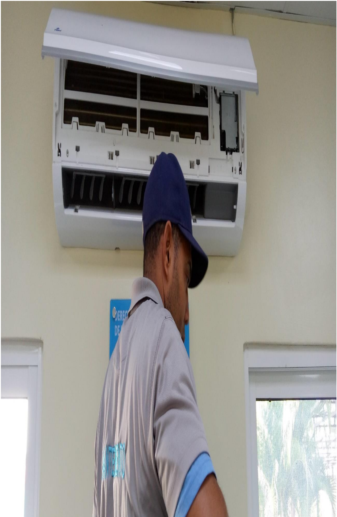
Aire acondicionado de emergencia 04/01/2024
