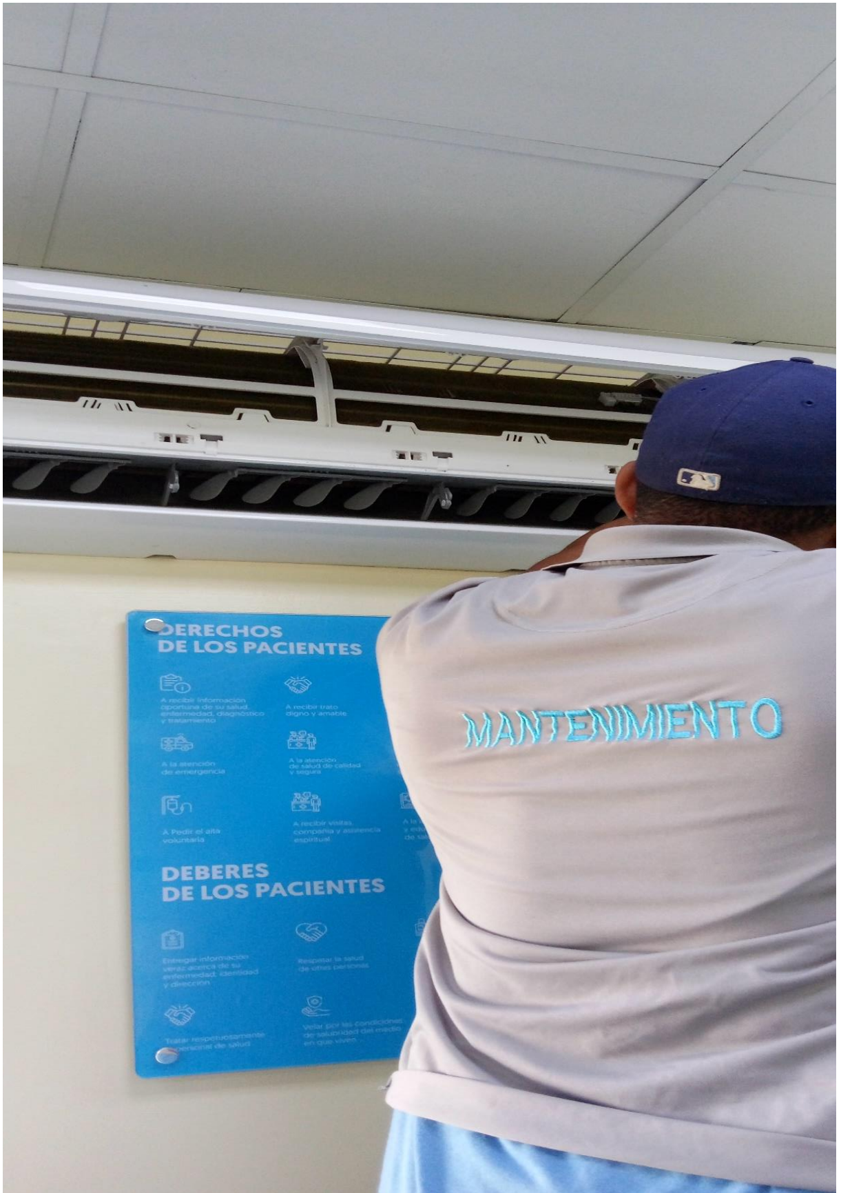
Aire acondicionado de emergencia 04/01/2024
