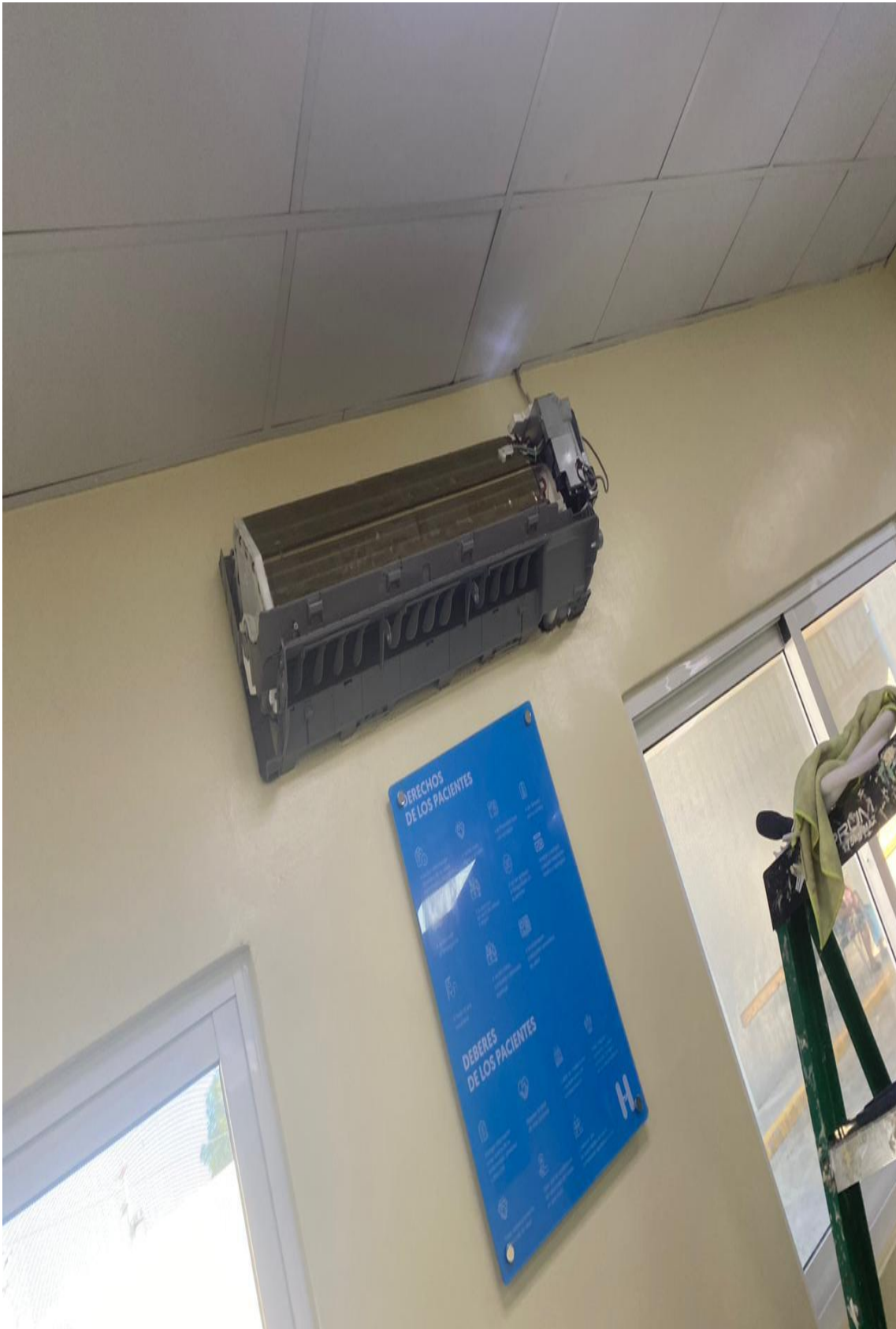
Aire acondicionado de emergencia 04/01/2024
