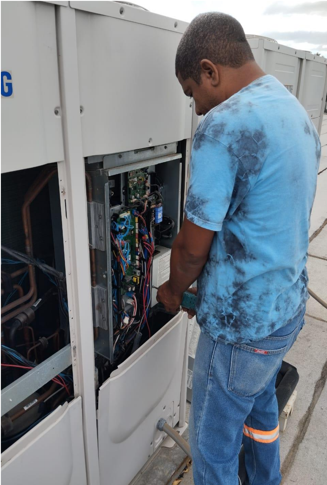
Mantenimiento aire central 24/01/2024
