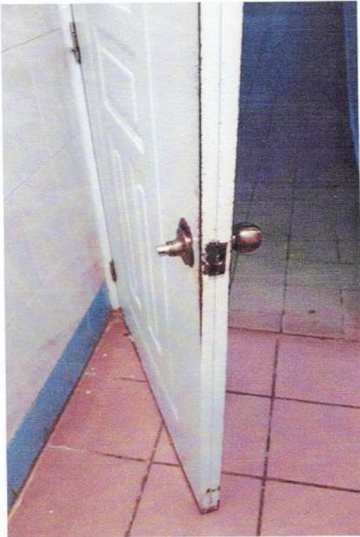
CONDICION DE LA CERRADURA BAÑO SOTANO
