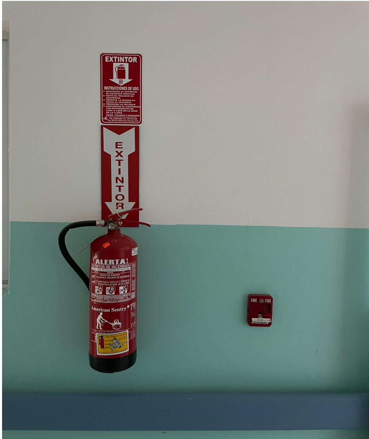
Extintor de incendios funcionando
