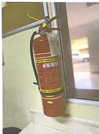
Extintor de incendios funcionando
