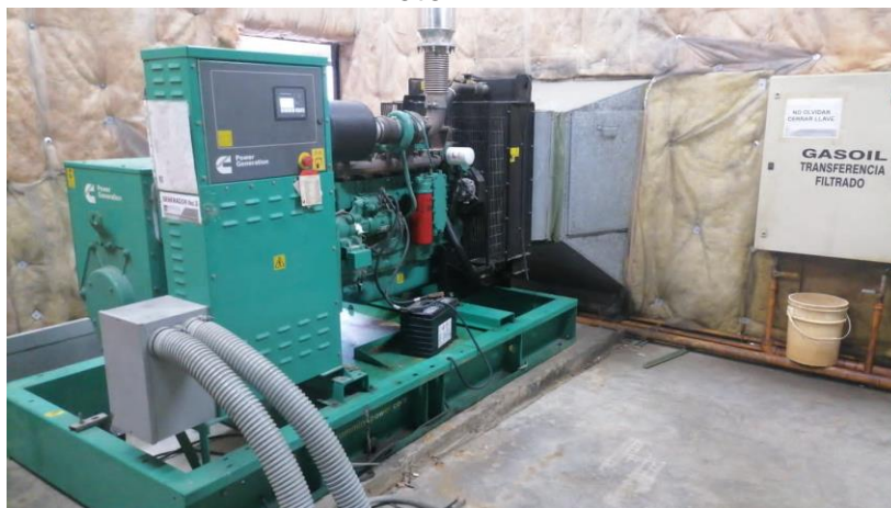
Generador # 3 (a la entrada del cuarto de maquina)
