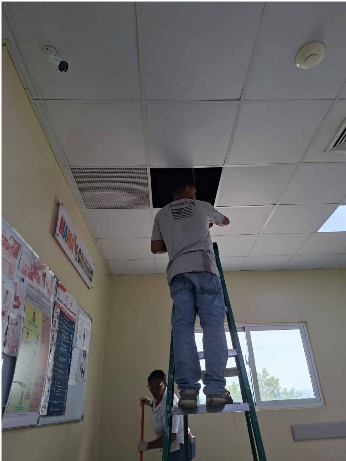
Mantenimiento Preventivo Drenaje de Aire en Mamá canguro 10/05/26
