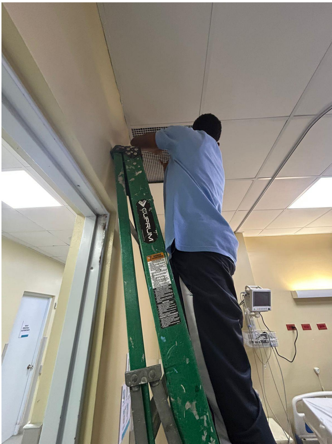
Mantenimiento preventivo Limpieza de filtros en la sala de internamiento B 05/05/26
