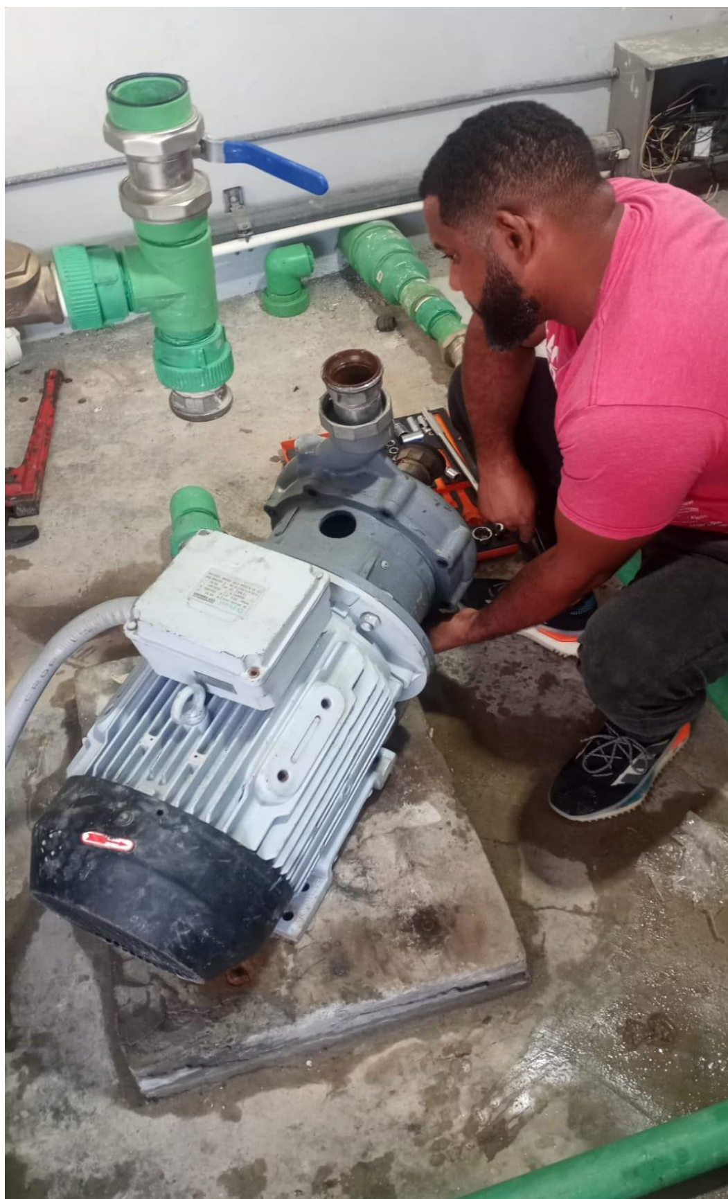
Mantenimiento Preventivo a la Bomba de Agua Industrial 06/05/26
