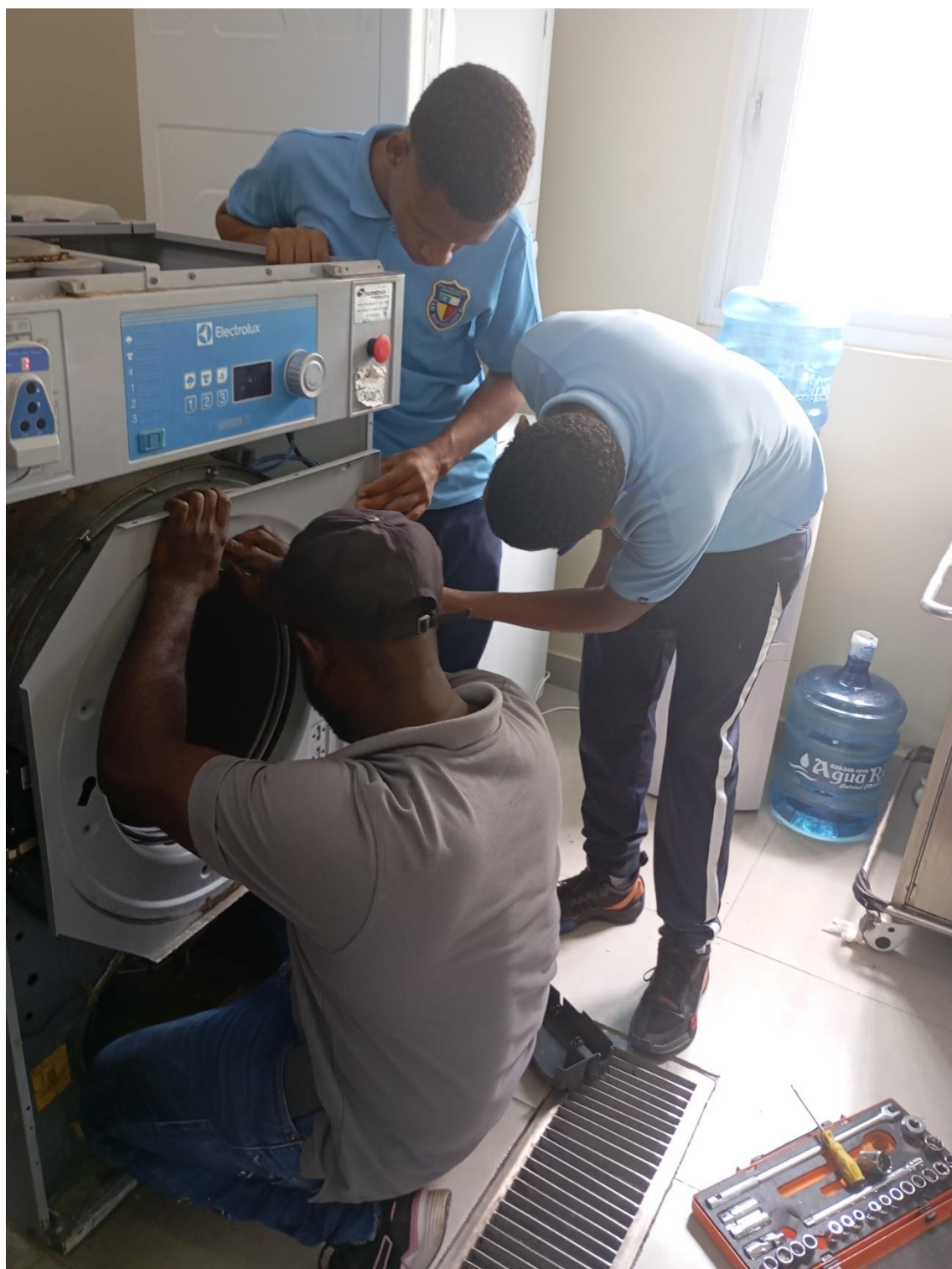
Mantenimiento Preventivo a lavadora industrial de lavandería 14/05/2026 .
