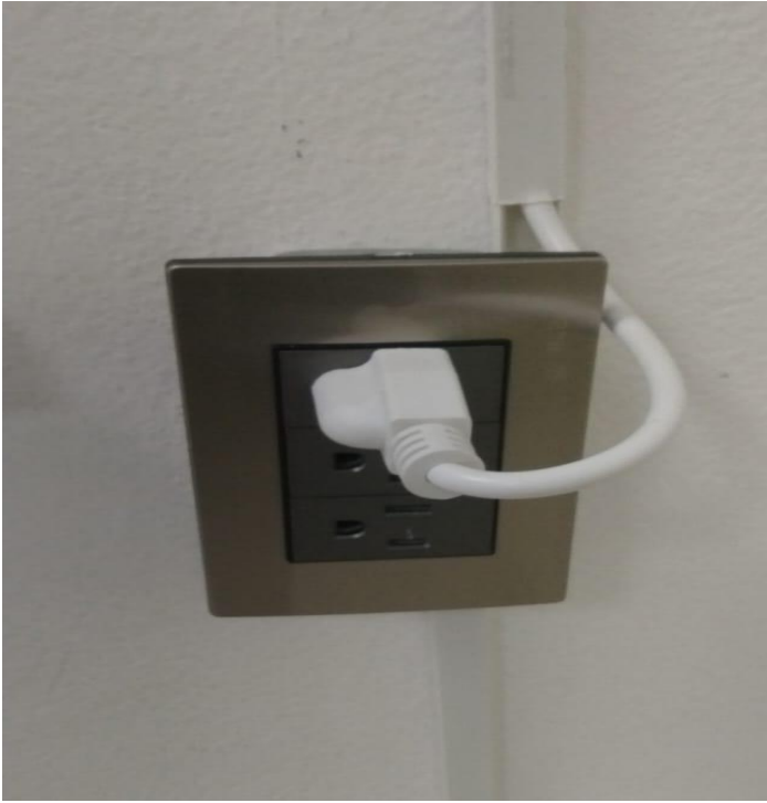
Salidas eléctricas tomacorrientes
