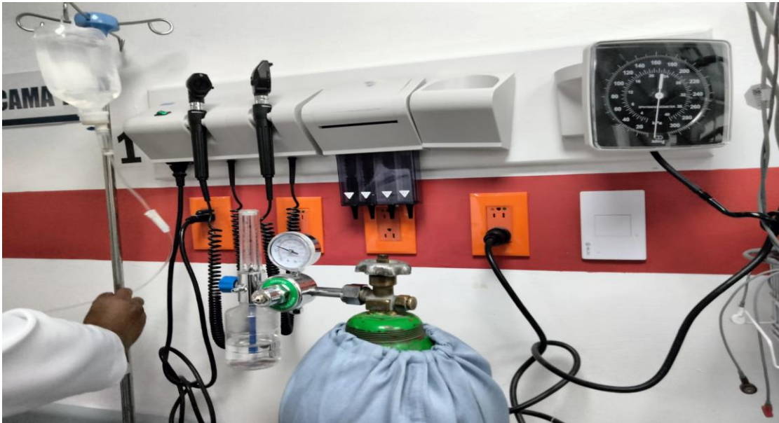
Mantenimiento Gases médico área de emergencia
