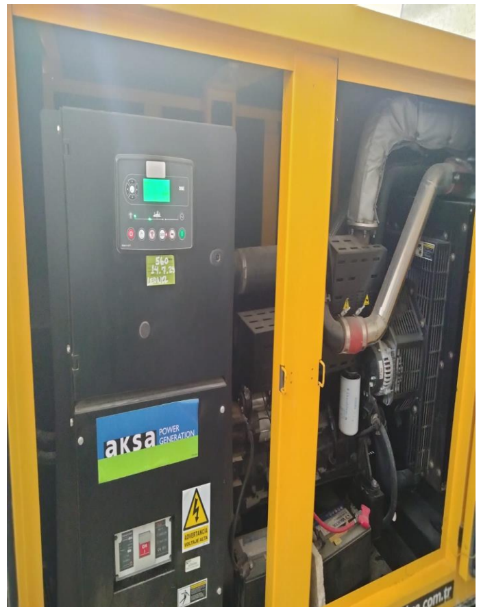
Generadores eléctricos de emergencia
