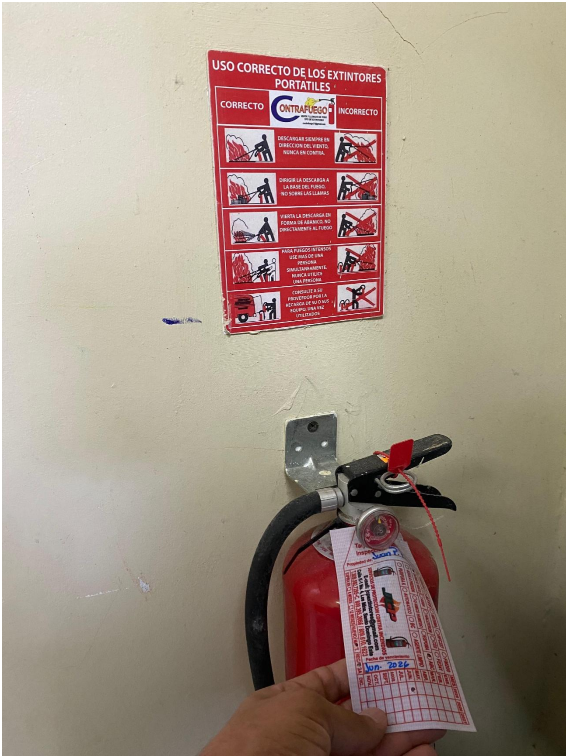
EXTINTOR DE FARMACIA CENTRAL AL DIA
