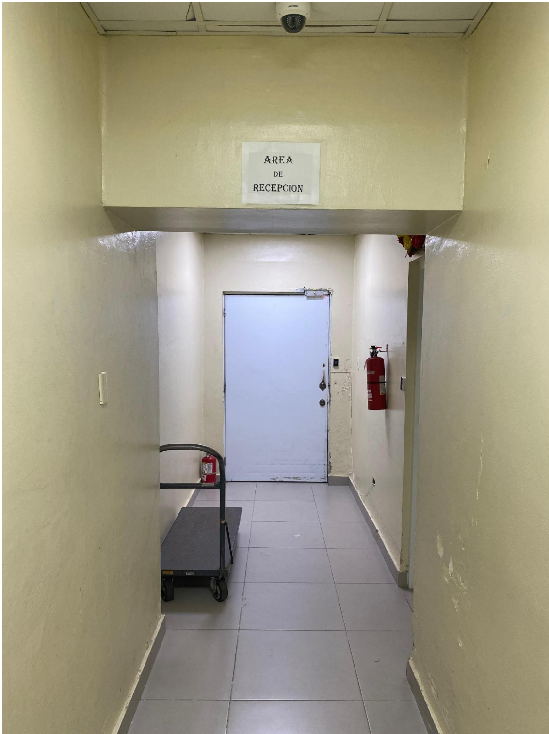
PASILLOS LIMPIOS Y SIN CAJAS OBSTRUYENDO ALMACEN DE MEDICAMENTOS
