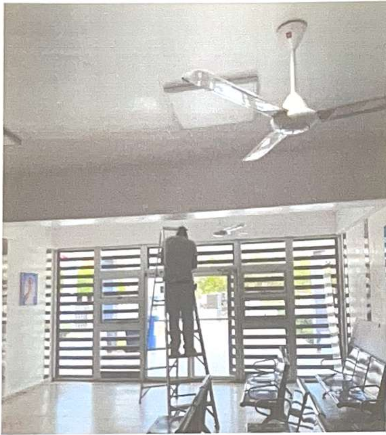
Luminarias zona perimetral (Externa)
