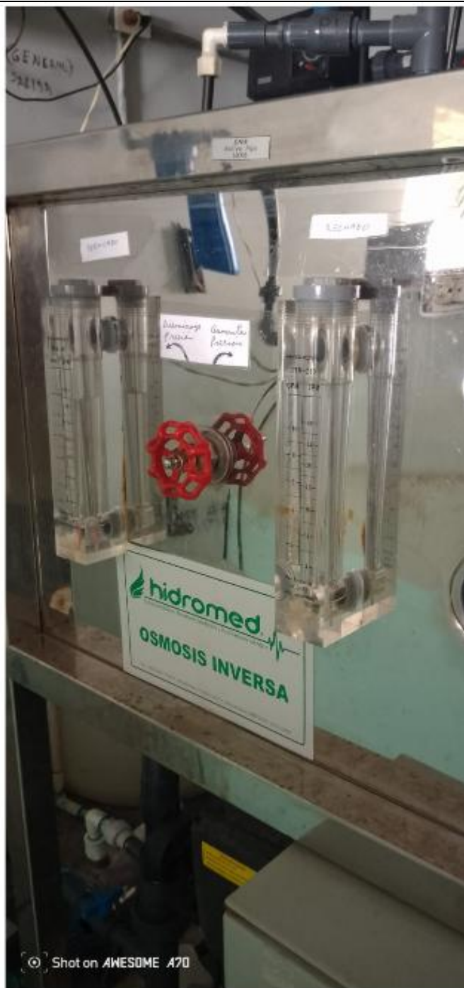
Membranas del sistema ósmosis inversa
