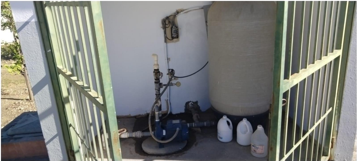
Bomba de agua – febrero 2026
