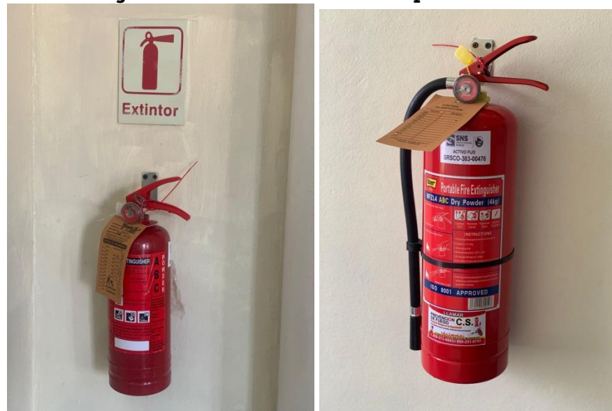
Adquisición e instalación de Extintor en Farmacia
