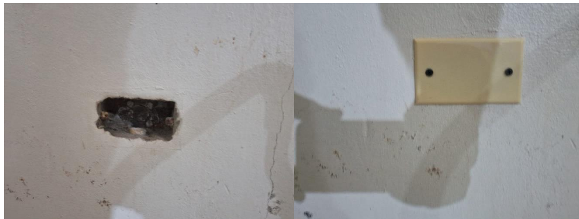
Colocación de tapitas en entradas de tomacorrientes que no están en uso.
