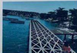
EL ALCALDE OSVALDO RODRIGUEZ SUPERVISA LA CONSTRUCCION DEL MUELLE PESQUERO EN LA RIVERA DEL RIO HAINA, GESTION 2024-2028. MARZO 2025.
