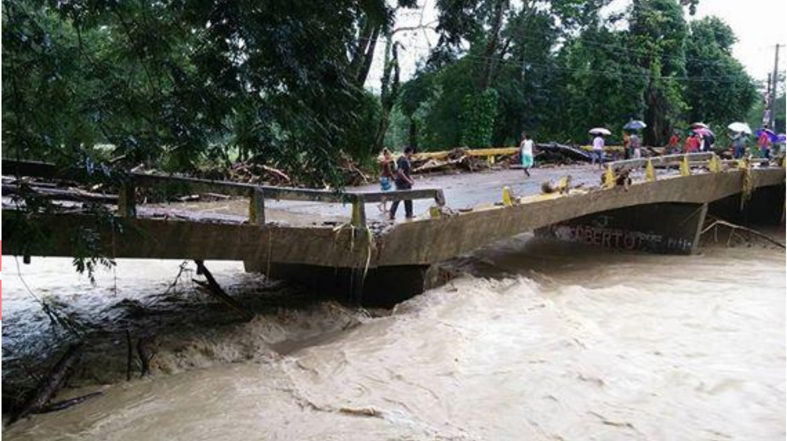
Vista de los colapsos ocasionados por las lluvias de 2017 en Jamao al Norte.
