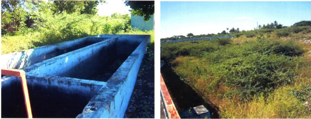
Planta de Tratamiento en completo abandono.
