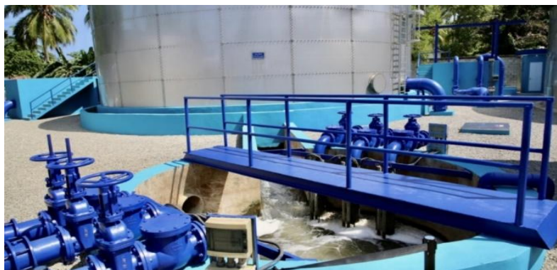
Vista parcial planta tratamiento agua residuales de Las Terrenas. www.ensequndos.do
