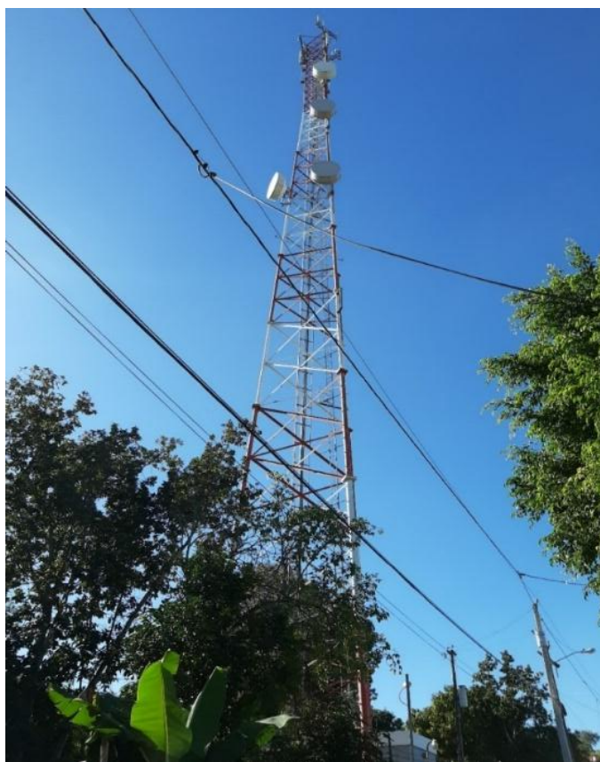
Antena de telecomunicaciones en Partido
