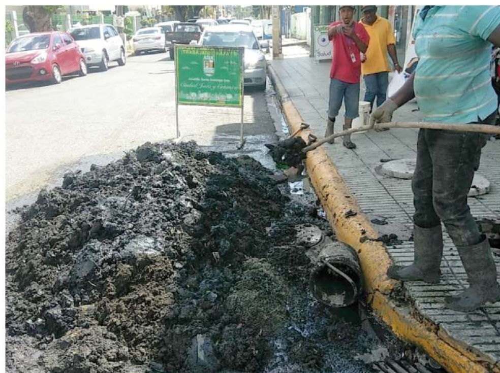
Lodo extraído desde la parte interior de un pozo filtrante.
