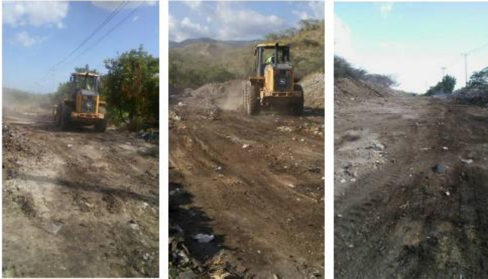
Fig. 28 - Vertedero municipal en mantenimiento
