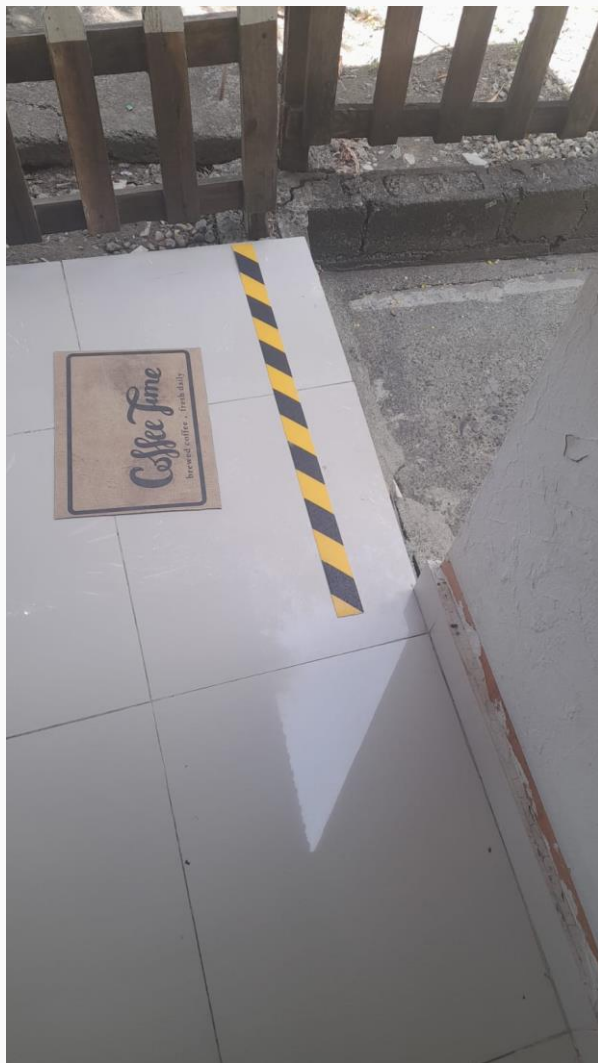
Evidencia 11: Adecuación de rótulos informativos de seguridad en accesos operativos.
