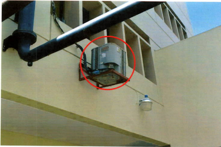
3. Riesgo de caída de unidades de A/A.
