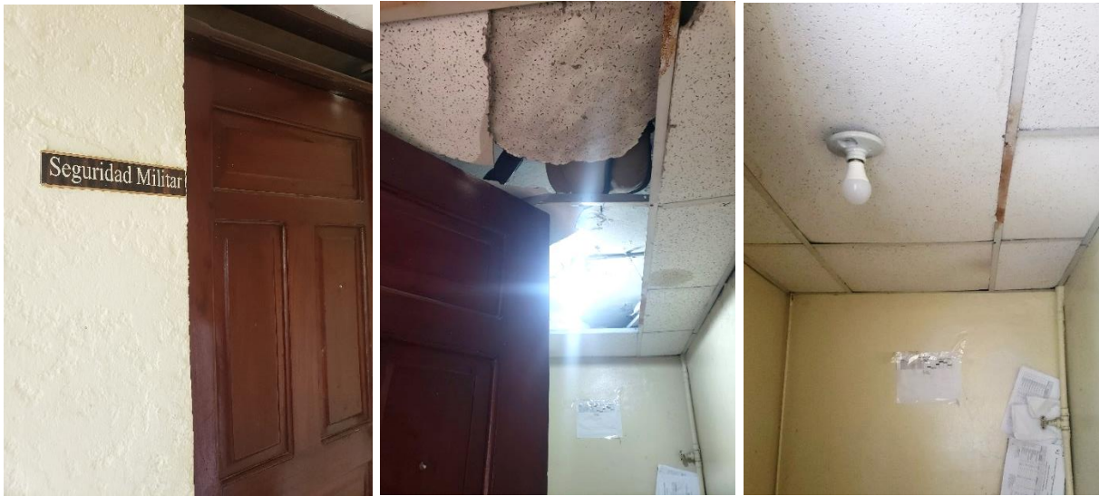
Ubicación: Cuarto de la Seguridad Militar
