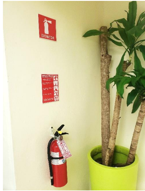
Ubicación: Interior. Recibidor o sala de estar. Intersección Planificación y Desarrollo, UAI, OAI.
