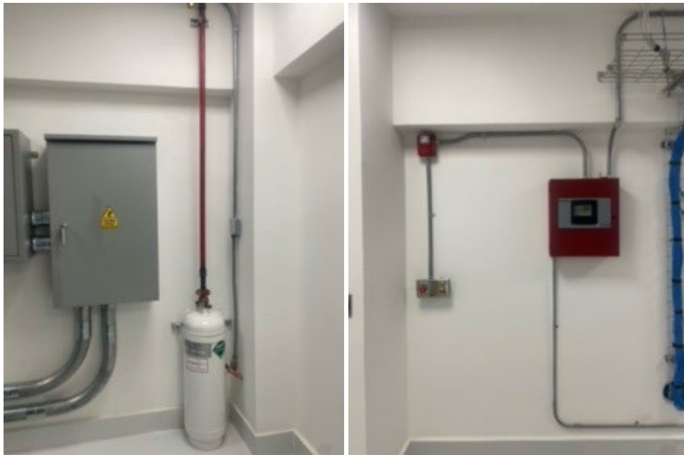
Señalización de supresión de agente limpio para el data center.
