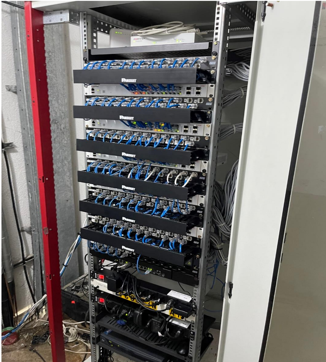
En la foto se muestra el cambio de los switches principales y la reorganización y actualización de los backbone del piso 3.
