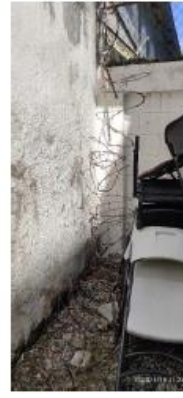
Alambre y escombros en la ruta de la emergencia
