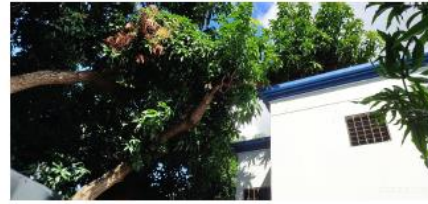
Parte de un árbol en el techo del local
