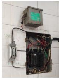
Área de breaker sin tapa de protección
