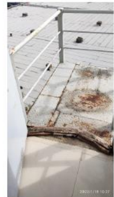
Filtración del agua desde el exterior
