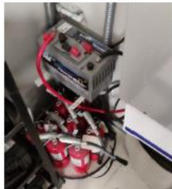
Extintores en el cuarto eléctrico
