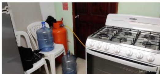
Tanque de gas y estufa de la cocina del sótano.
