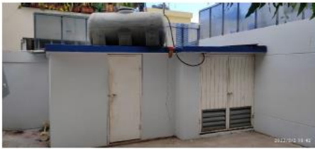
Tanque de combustible en la orilla del techo sin anclaje
