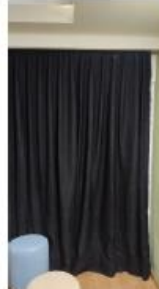
Puerta de escape cubierta por cortinas
