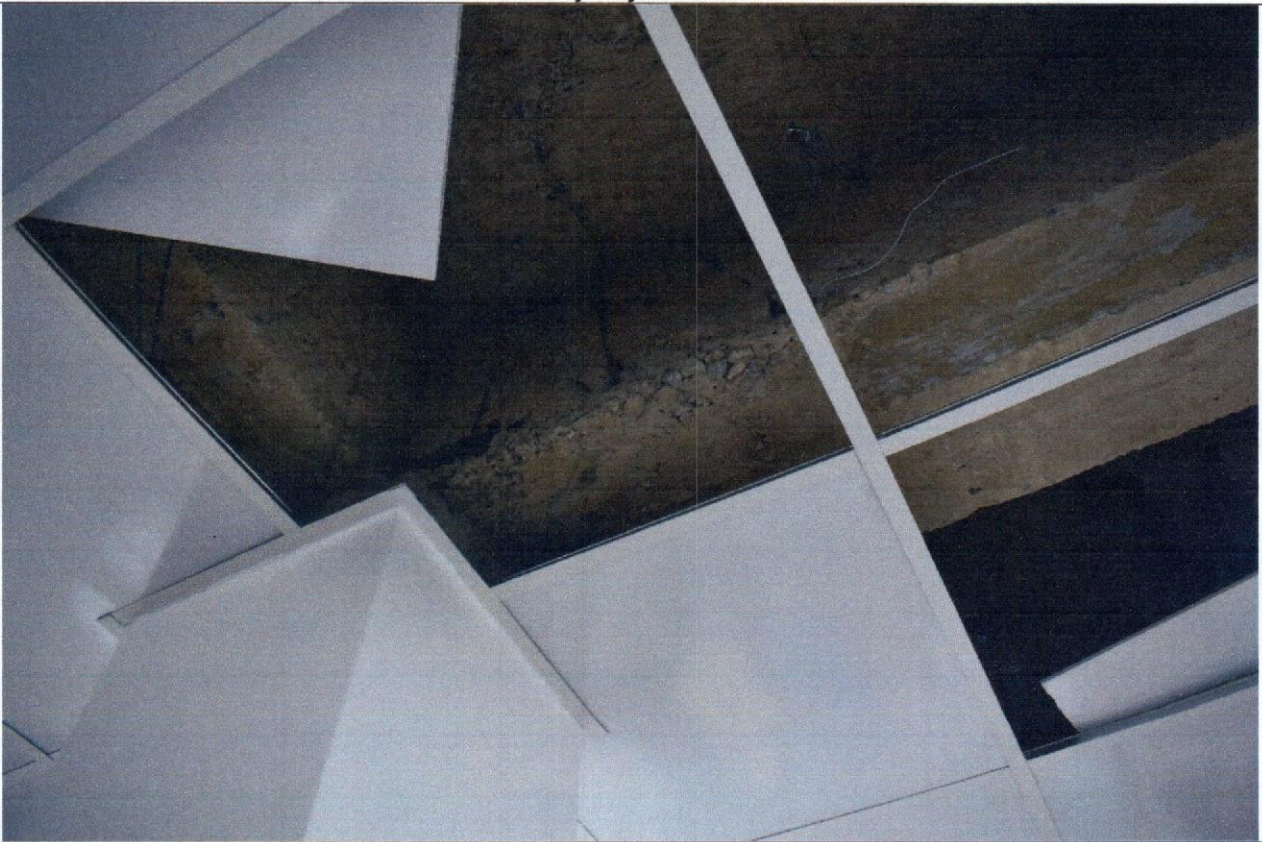
Acero Expuesto en viga y losa por vaciado deficiente.
