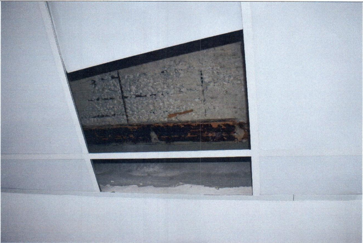
Acero descubierto y baja calidad en el vaciado
