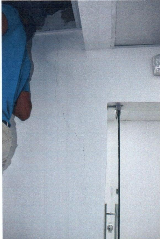
Grieta en muro pandereta
