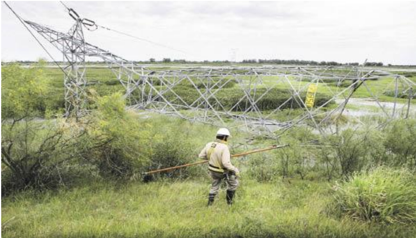
Colapso líneas de transmisión...
