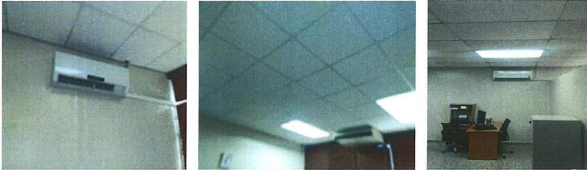
Foto No.7 Vista de los acondicionadores de aires instalados en todas las oficinas de Ina DGM
