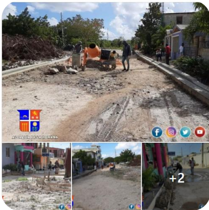
CONTINÚAN LOS TRABAJOS DE CONSTRUCCIÓN DE ACERAS Y CONTENES EN EL SECTOR DE VILLA SAN CARLOS.
