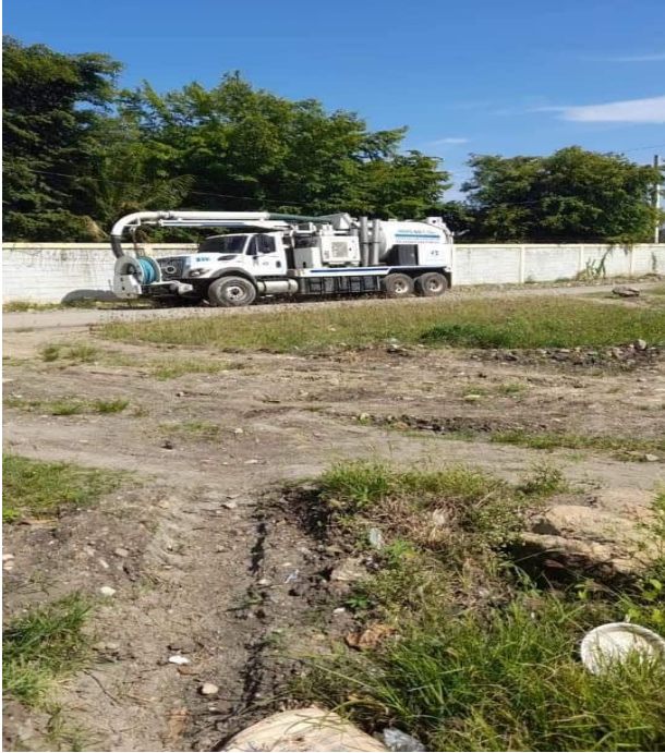
Limpieza del sistema de cloacas en Villa Progreso en la comunidad de Guama Abajo.
