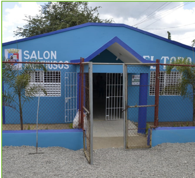
Remozamiento total del Multiuso de la sección El Toro, una obra que era reclamada por esta comunidad desde hacía varios años.
